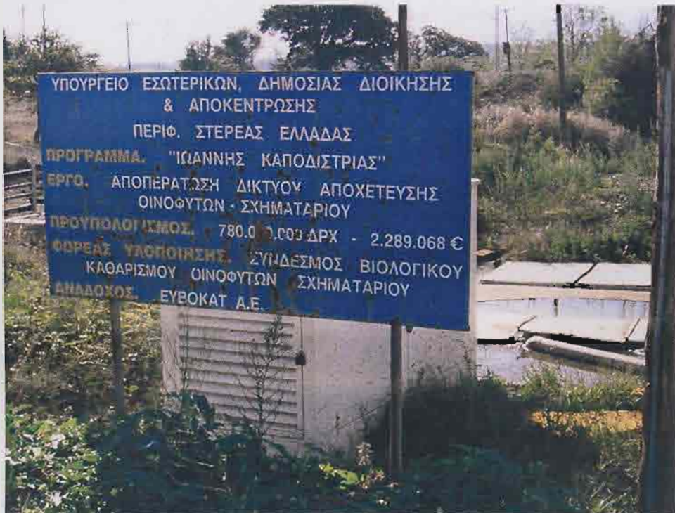
ΚΕΝΤΡΙΚΟ ΑΝΤΛΙΟΣΤΑΣΙΟ ΛΥΜΑΤΩΝ ΣΤΑ ΟΙΝΟΦΥΤΑ
